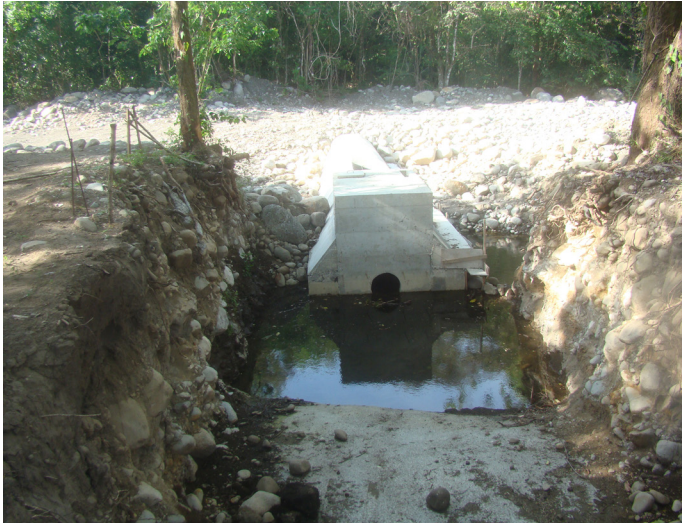
Figura 1. Toma de aguas del IDAAN
