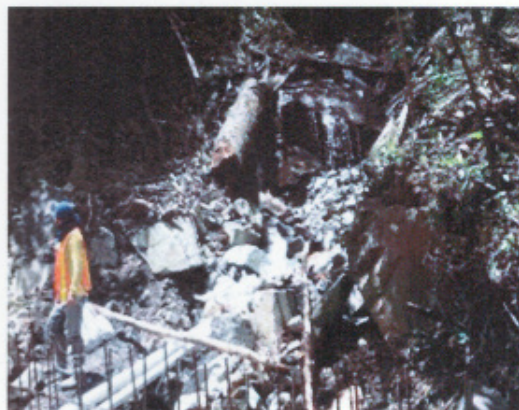
FIGURA 35. Fuente hídrica impactada directamente en el cauce.
