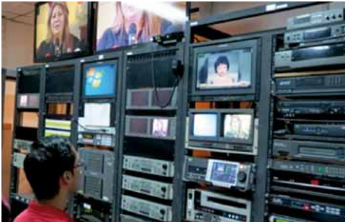
Foto 1. Control central y departamento de emisión Canal 13 – Costa Rica
